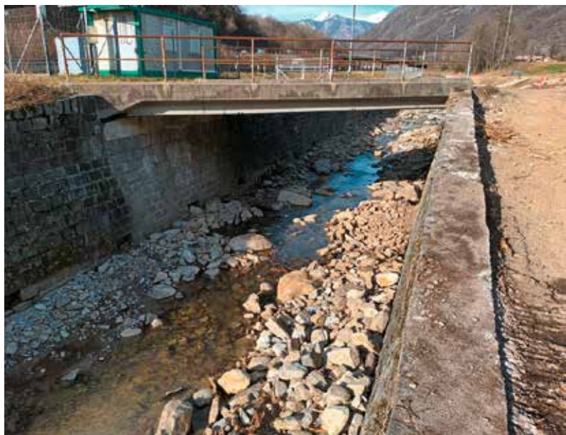
Lungo il torrente, rampa di risalita ittica in pietrame realizzata nei pressi della foce (foto di Marco Somaschini).
